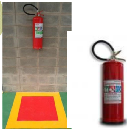
Extintor de pó químico seco - ABC
